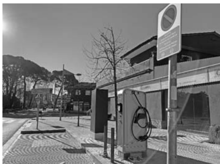
S'instal·la el primer punt de càrrega de vehicles elèctrics.
