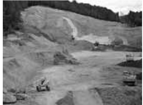
Detall de la destrucció del paisatge en un petit tram de l'obra del Quart Cinturó.
