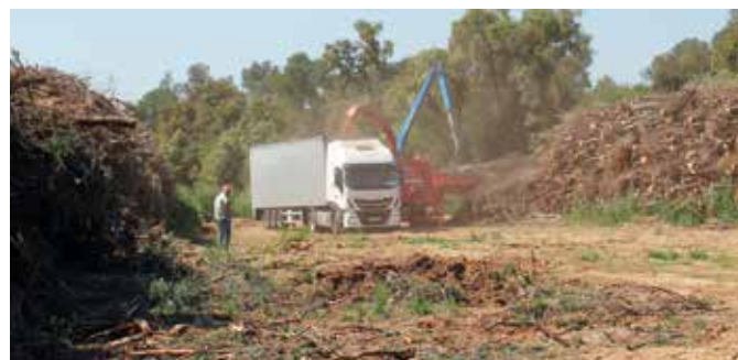
Un camió retirant l'arbrat mort a Santa Eulàlia
