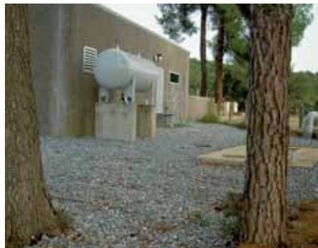
Noves instal·lacions per l'abastament d'aigua potable.
