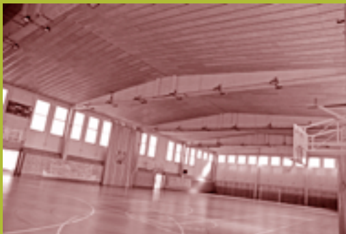
El pavelló poliesportiu patia filtracions d'aigua quan plovia
