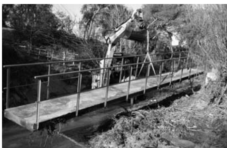
La passera de la Campinya que es va desplaçar.
